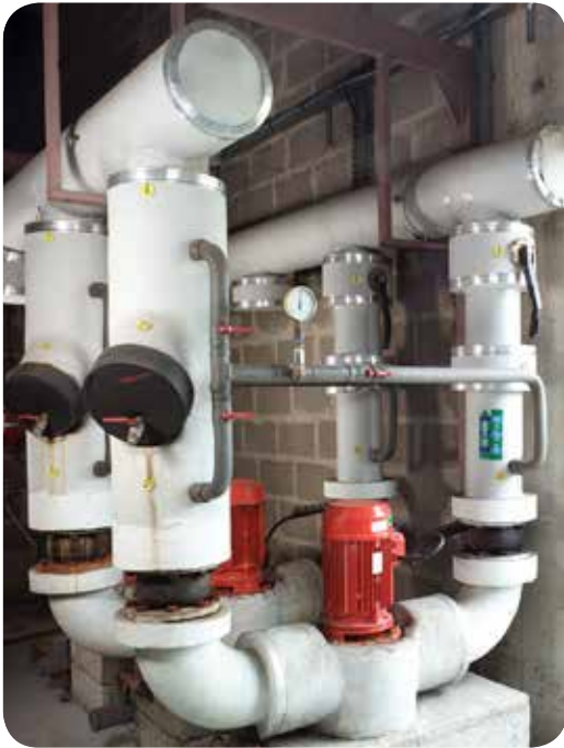
采用ATS 22软起动-软停止单元的泵应用实例
